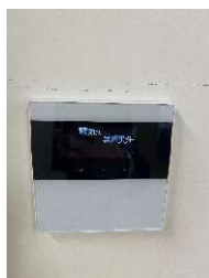
ゾーニングのカード錠システム (山形県川西町役場)
