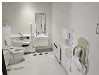
多目的トイレ (双葉町役場)
