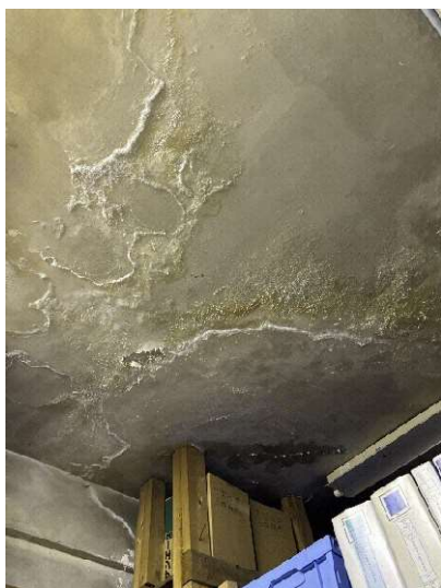
書庫内の雨漏り
