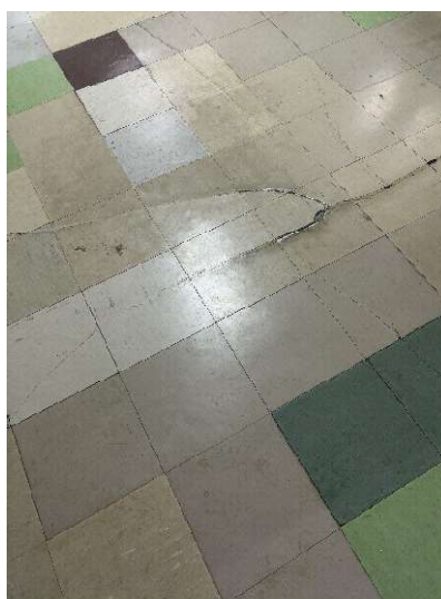
町長室前廊下のひび割れ
