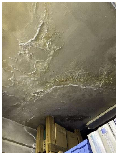
書庫内の雨漏り
