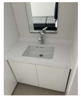
洗面化粧台 (会津若松市役所)
