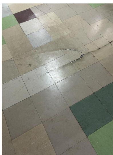
町長室前廊下のひび割れ
