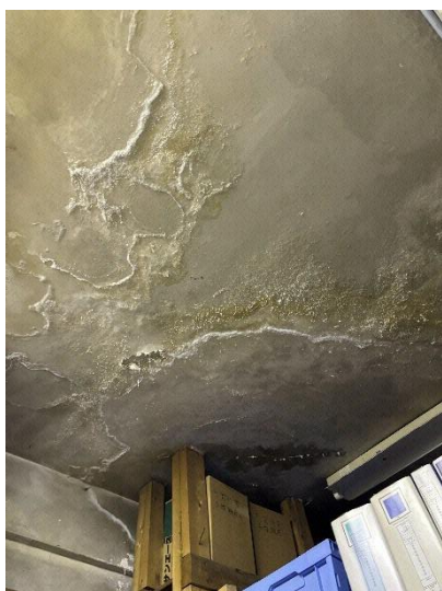
書庫内の雨漏り
