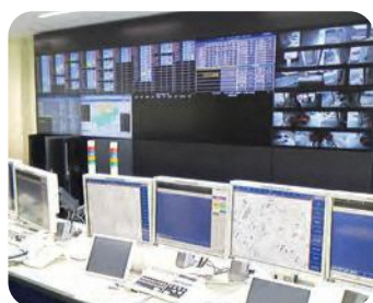
消防本部通信指令センター
