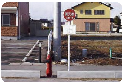
しょうかせん 消火栓
