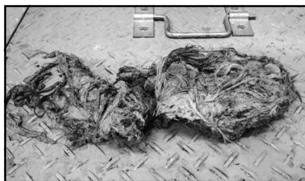
↑浄化センターのポンプに詰まった布製品の写真
