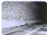
天井裏断熱のための吹き付けアスベストの状況
