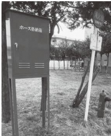
地域防災の頼りになる消火栓
