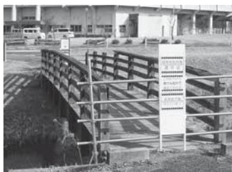
1日も早い修繕が望まれる 鶴沼緑地公園歩道橋
