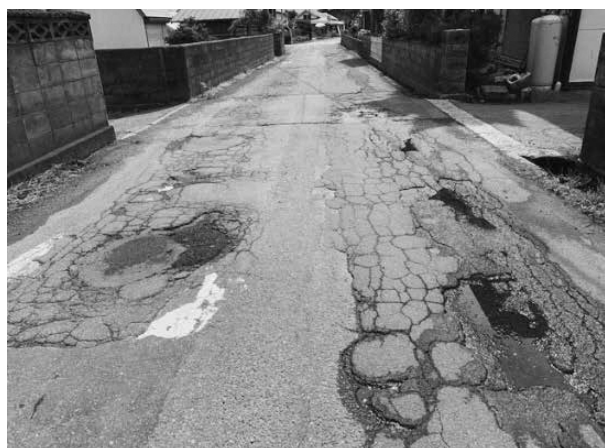
補修されず劣化が進む幹線道（牛沢）
