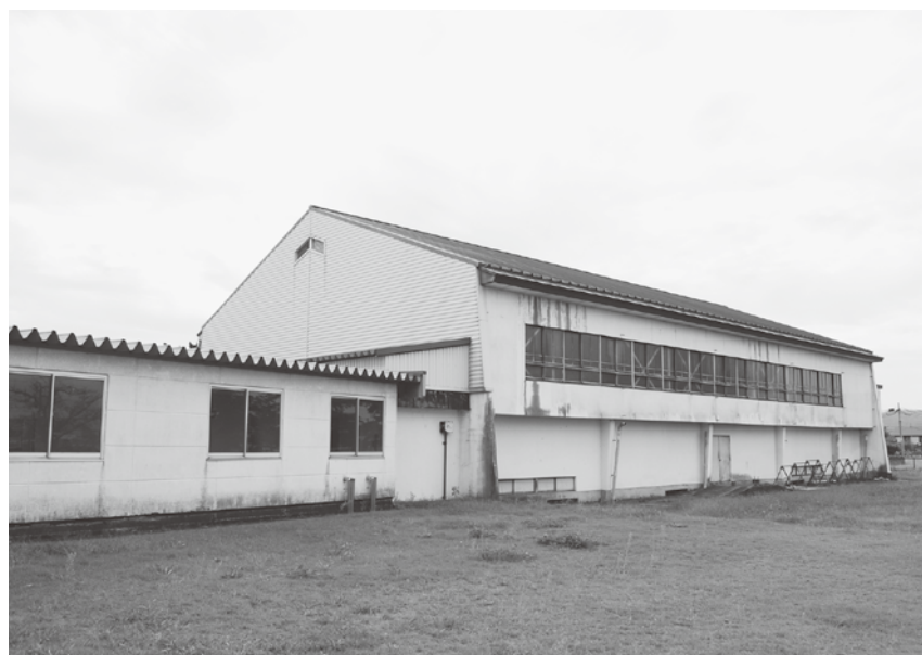
老朽化の進む金上コミュニティセンター体育館
