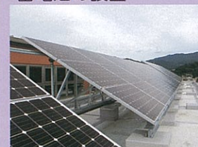
(屋上の太陽光発電パネル)
