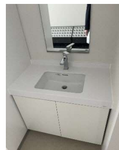
洗面化粧台 (会津若松市役所)
