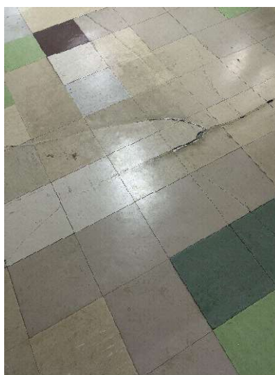
町長室前廊下のひび割れ
