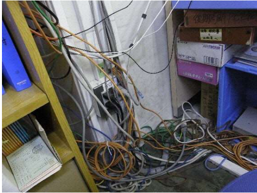
むき出しになった配線
