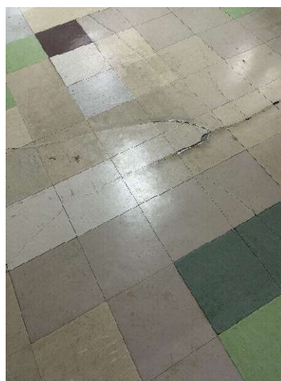
町長室前廊下のひび割れ
