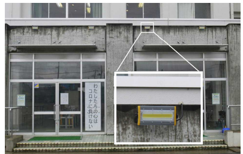
夜間照明4基と拡大写真
